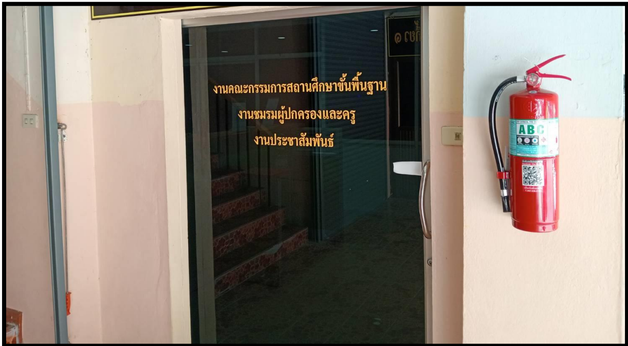
ภาพที่ ๓๘ การติดตั้งถังดับเพลิงบริเวณจุดต่าง ๆ ของโรงเรียน
