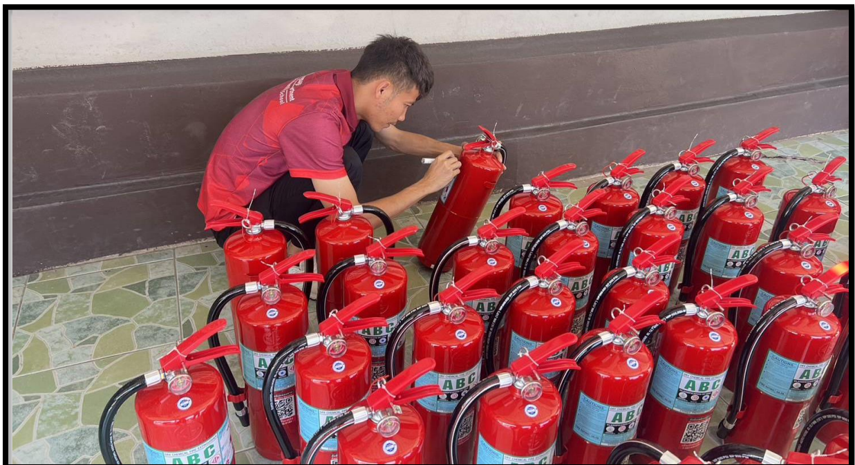
ภาพที่ ๓๗ การจัดเตรียมถังดับเพลิงเพื่อป้องกันเหตุไม่พึงประสงค์
